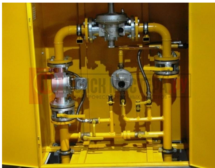
Рисунок 2 - Шкафный регуляторный пункт (ШРП)
