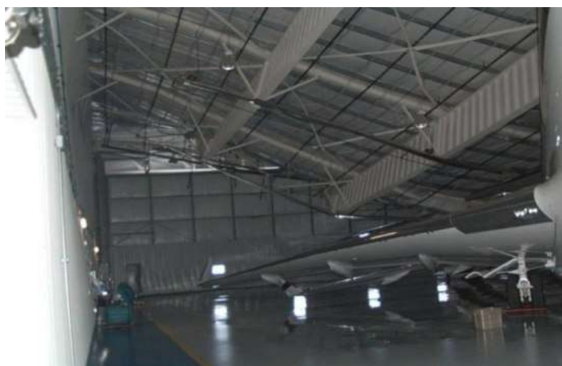
Рисунок 6 – Пример обрушения покрытия здания ангара для легкомоторных самолетов
