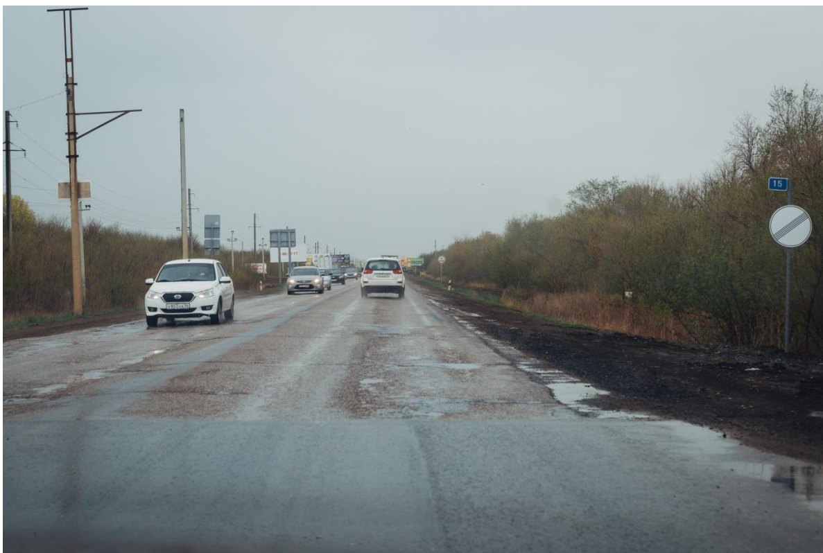
12 - Участок автомобильной дороги по Беляевскому шоссе (около Экодо- ля)
