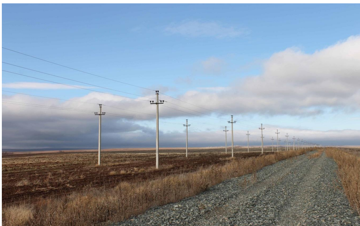
Рисунок Д.8 – Фото опор ЛЭП, питающих БКЭС
