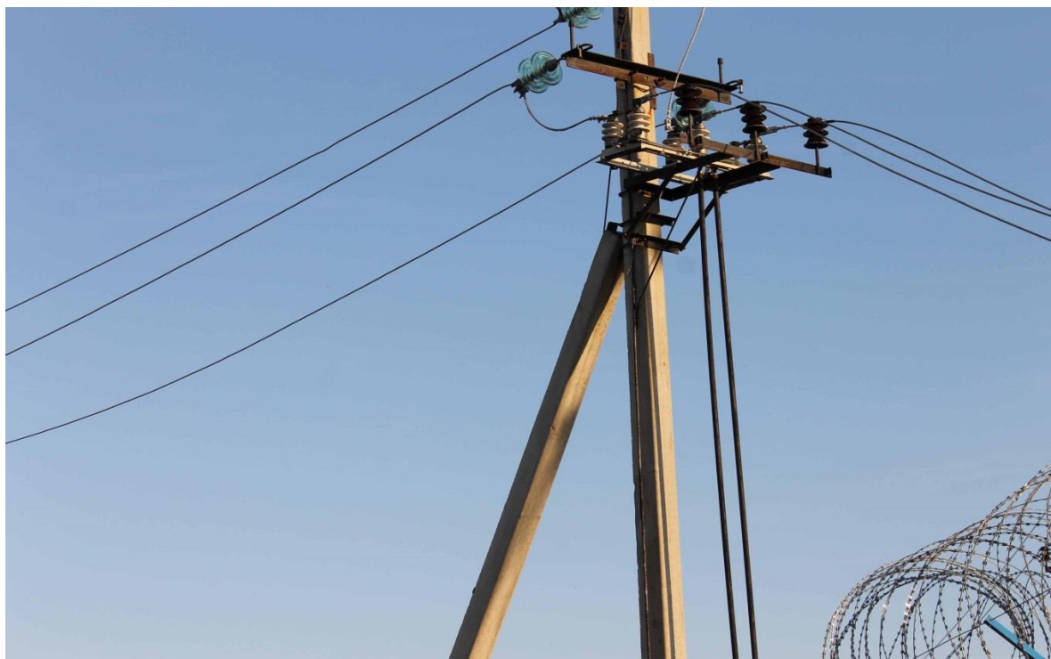
Рисунок Д.7 – Фото опоры ЛЭП при подводе к БКЭС
