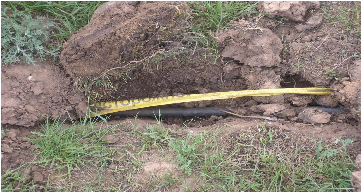
Рисунок Д.3 – Фото выступающего из-под земли оптического кабеля АСУ ТП: глубина прокладки кабеля менее 10 см (требуемая глубина 1.2 м)
