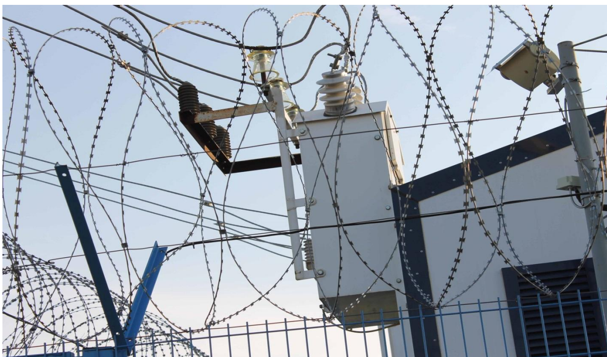
Рисунок Д.6 – Фото ввода ЛЭП, питающих БКЭС
