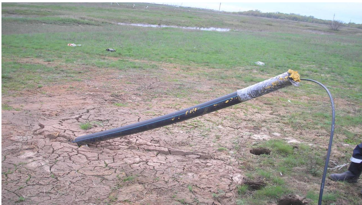
Рисунок Д.5 - Фото ВОЛС, выступающей над землёй на высоту более 1 м
